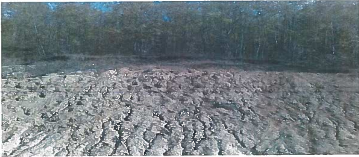
Fig. - 82 Erozion në Nikoliq (mbi rrugën Krumë-Golaj).
