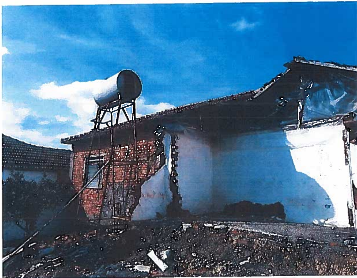
Banesë e dëmtuar dhe e rilevuar ne Njësinë Administrative Xhafzotaj
