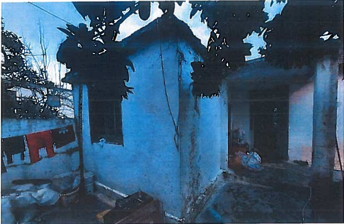
- Banesë e dëmtuar dhe e rilevuar Njësinë Administrative Shijak
