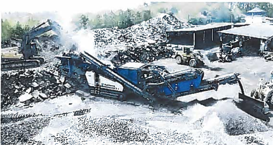
Figura 67 Elementet e një impianti të lëvizshëm për trajtimin e MNP dhe një në operim 53
